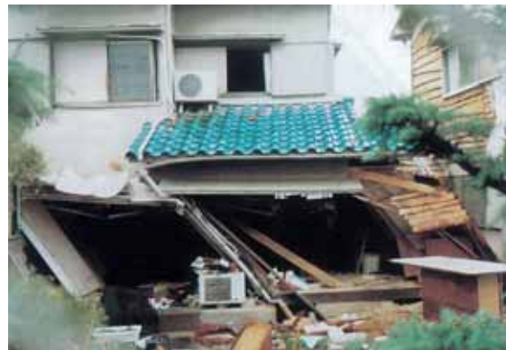
図-3 壁量不足で大傾斜した住宅(阪神大震災) (出所)財団法人日本建築防災協会「戸建て住宅 耐震改修工法・事例」(平成14年)p3より。
